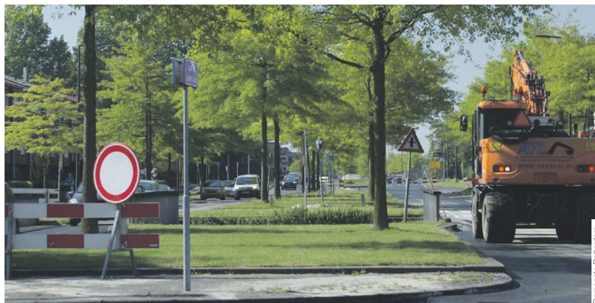
De Laan van Avant-Garde krijgt nieuw asfalt en is daarom tot eind mei afgesloten richting de Brandingdijk.
