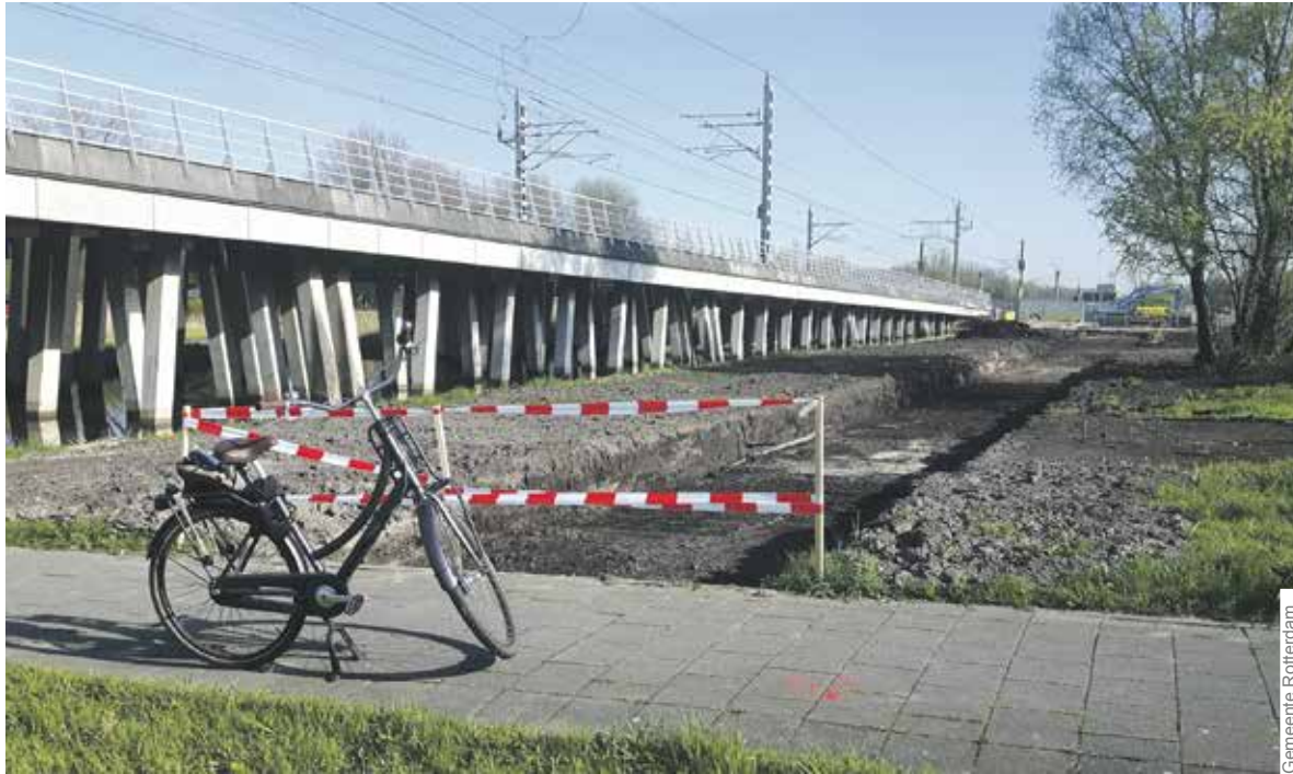
Werk in uitvoering! Eind juli ligt hier het nieuwe Bovenpolderpad en is de fietsroute vanuit Park 16Hoven rechter en sneller.
